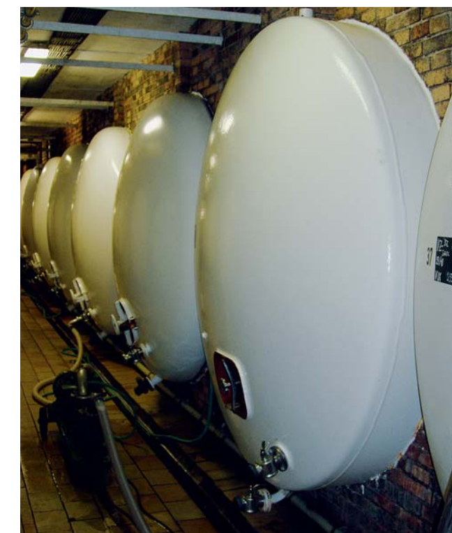
Obr. 7-6: Ocelové ležácké tanky
